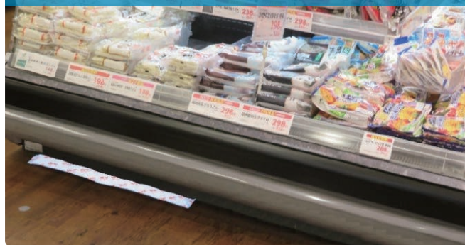
スーパー・店舗の冷凍ショーケース
