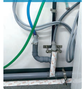
ビル内の給排水設備
