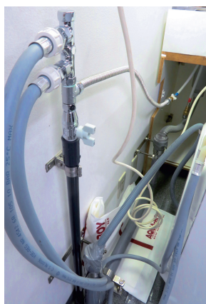
水廻り設備からの漏水 : LH-1、LQ-1
